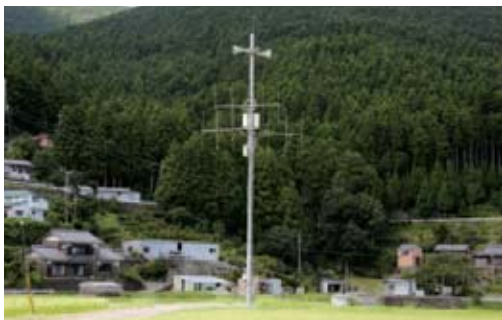
台風 12 号の浸水高よりも高い位置に機器が設置された防災行政無線屋外子局（浅里地区）
