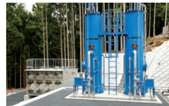
完成した浅里地区専用水道施設
