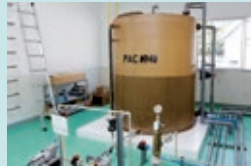
凝集剤注入設備
