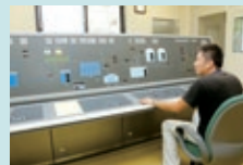
中央制御監視室
