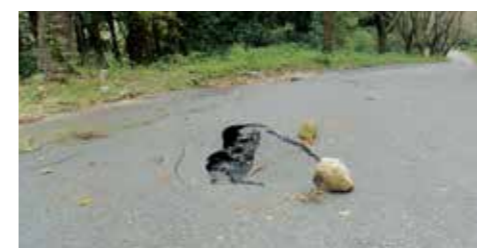
陥没した道路
