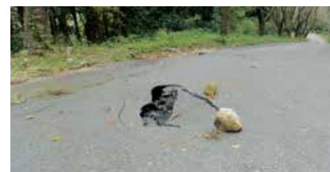
陥没した道路
