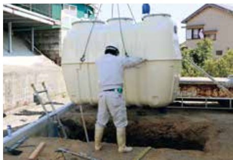
合併処理浄化槽
