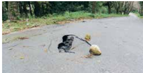
陥没した道路
