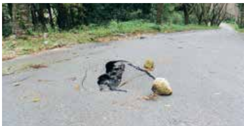
陥没した道路
