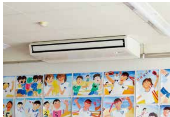
小学校に整備された空調設備
