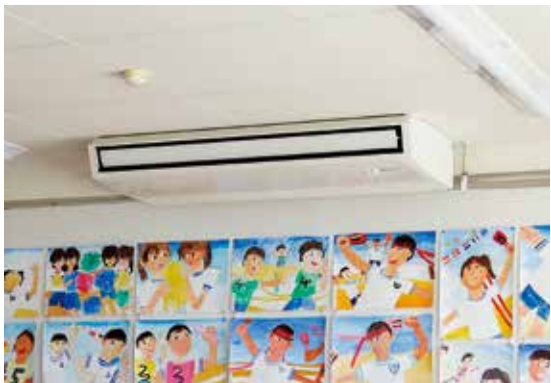
小学校に整備された空調設備
