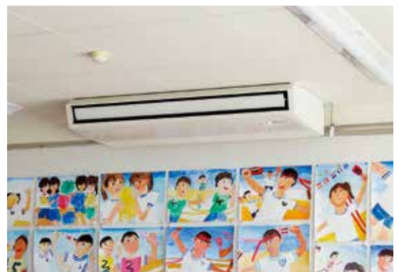
小学校に整備された空調設備
