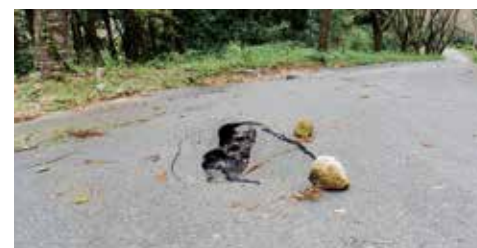
陥没した道路
