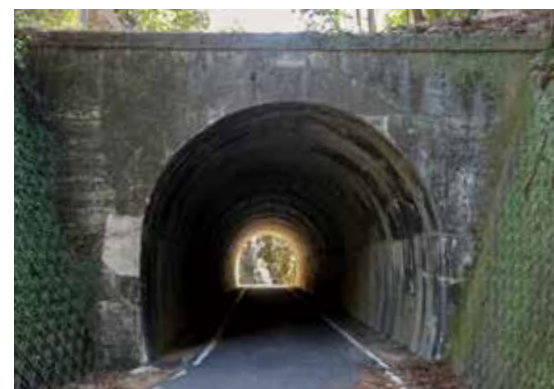
封鎖される旧相野谷トンネル
