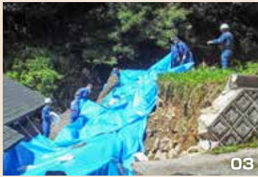
01. 大里永田地区で川の氾濫状況を確認する町職員と消防団員。02・03. 消防団による復旧活動。
