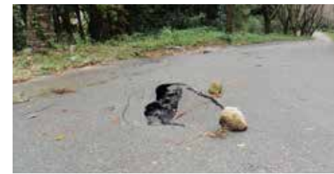
陥没した道路
