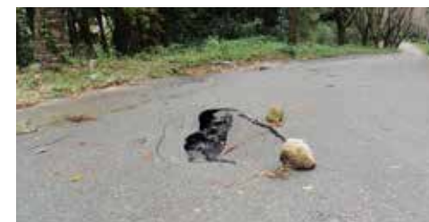
陥没した道路
