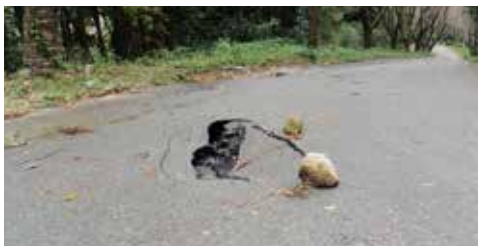
陥没した道路
