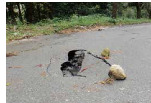
陥没した道路
