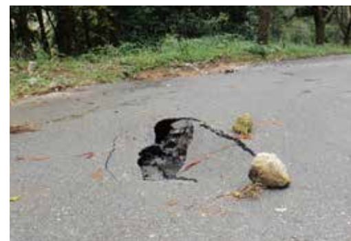
陥没した道路
