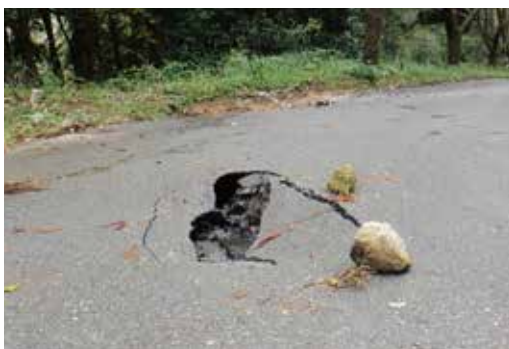
陥没した道路
