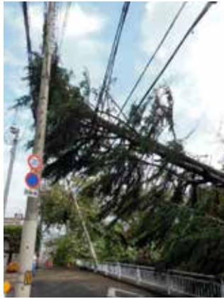
樹木が倒れ電線が損傷
