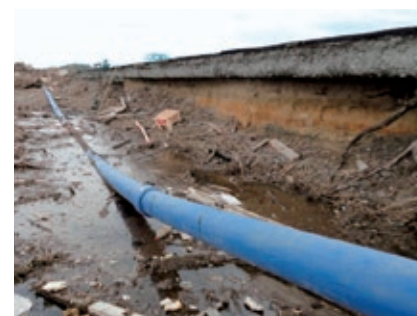
福岡県南相馬市の被害状況 （写真提供：配水用ポリエチレンパイプシステム協会）
