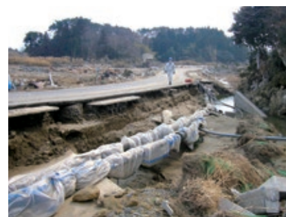
宮城県東松島市の被害状況 （写真提供：日本ダクタイル鉄管協会）
