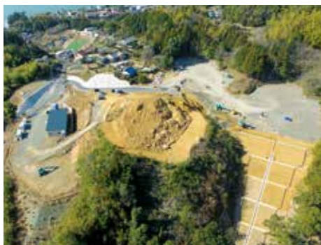
大規模災害時の避難場所、活動拠点となる成川高台整備
